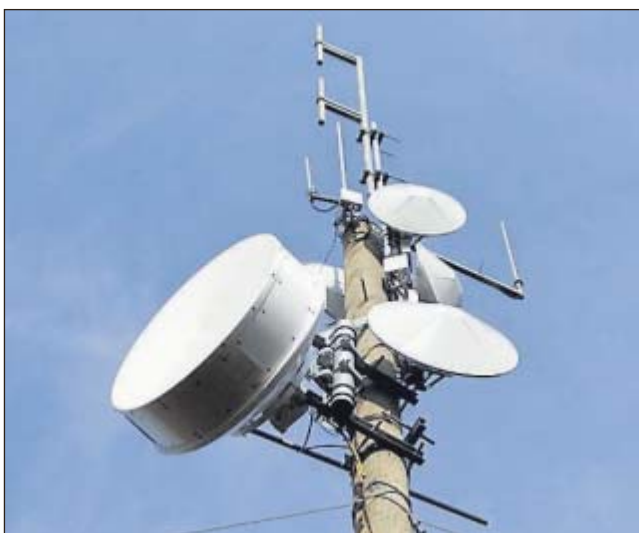
FORMIDLER BREDBÅND: Via denne antennen på Vardeåsen i Aremark vil flere markinger kunne få bredbånd.
